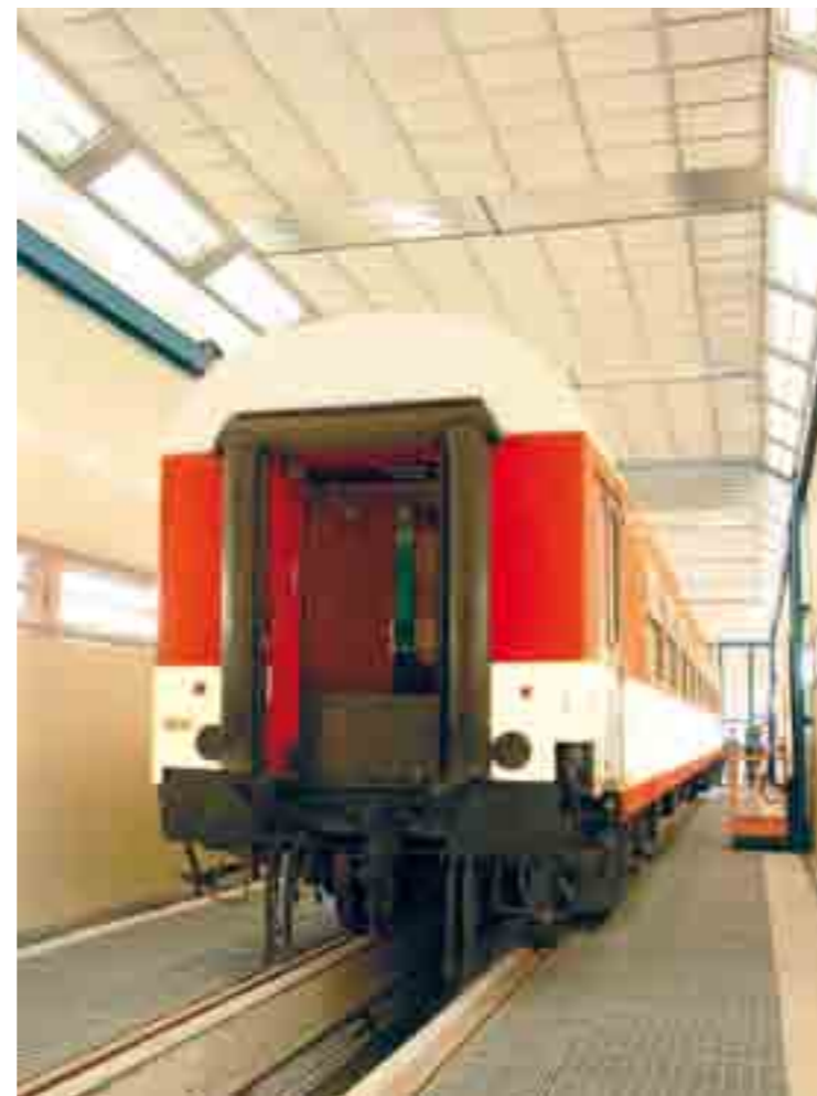
Cabina forno per carrozze ferroviarie.
